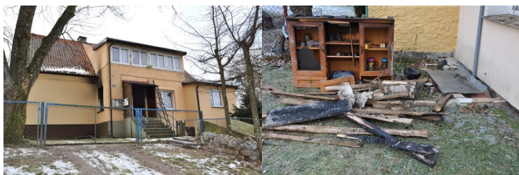
budynek po pożarze
