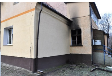
budynek po pożarze
