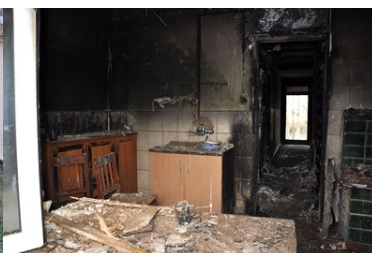
budynek po pożarze
