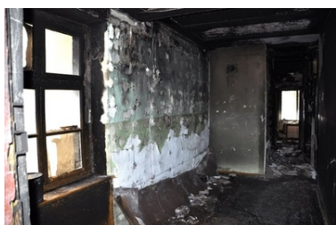
budynek po pożarze
