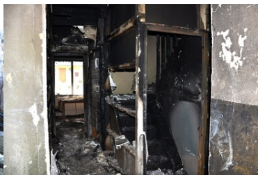
budynek po pożarze
