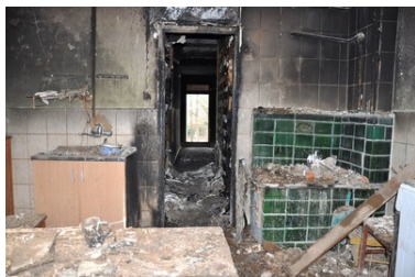
budynek po pożarze
